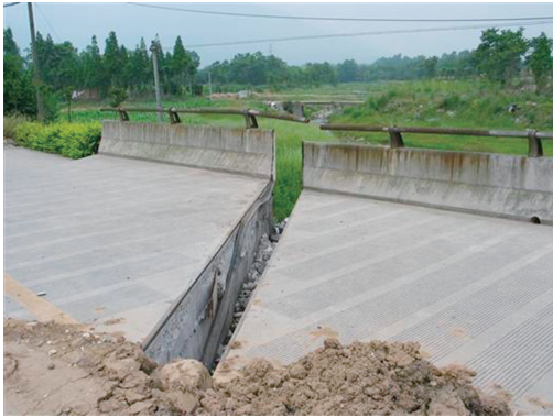
图 1 桥梁伸缩缝地震破坏
