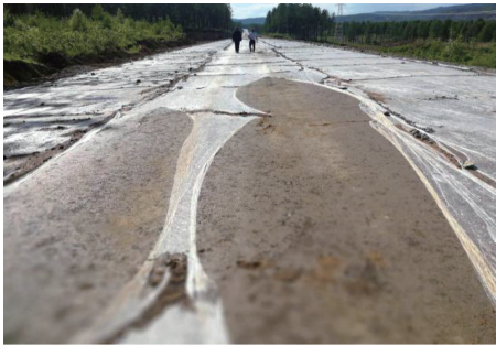
(a) 薄膜苫盖不严, 破损无法恢复
