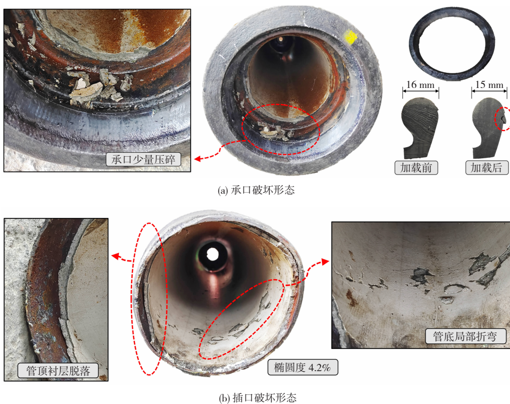
图 10 DN150 管道承插口屈曲变形
