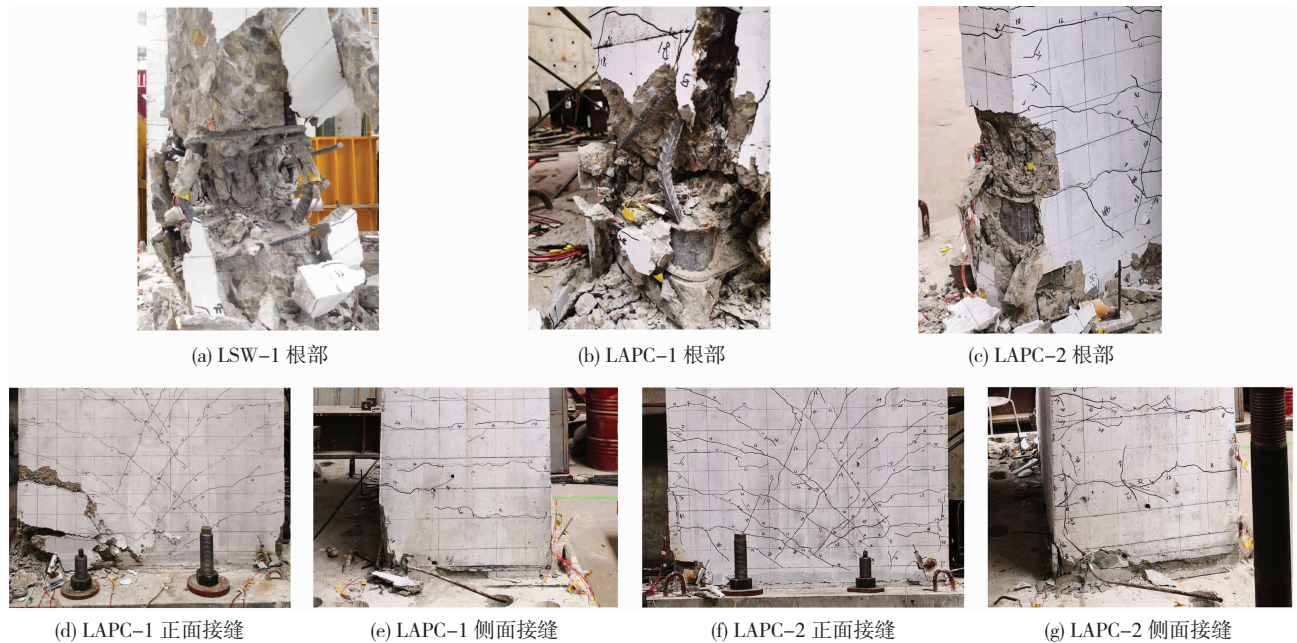
图9 极限荷载时 L 型剪力墙根部及灌浆接缝破坏情况
