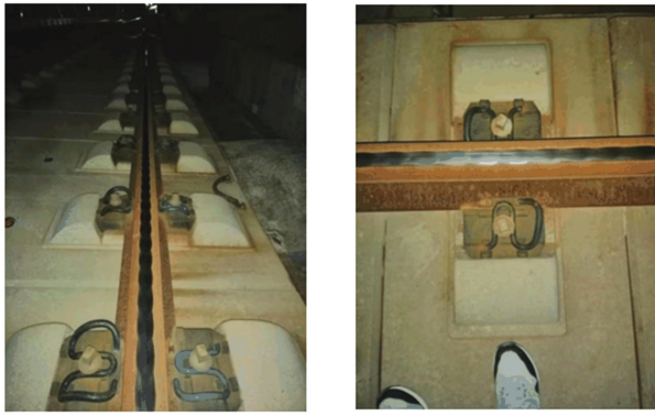
(a) 弹条断裂情况 1 (b) 弹条断裂情况 2
