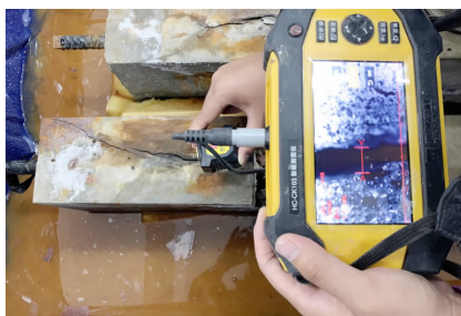
图 3 混凝土表面锈胀裂缝观测
