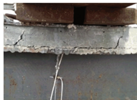
(b) 加载点下方混凝土开裂
