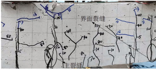
图 6 破坏时主裂缝及界面裂缝比较
