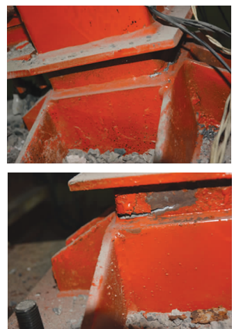
(b) 柱脚损伤
