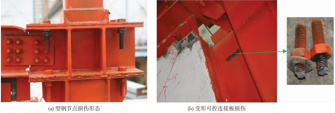
图 10 轻型装配化部件损伤
