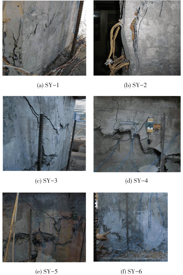
图 13 混凝土板墙加固砖墙破坏情况
