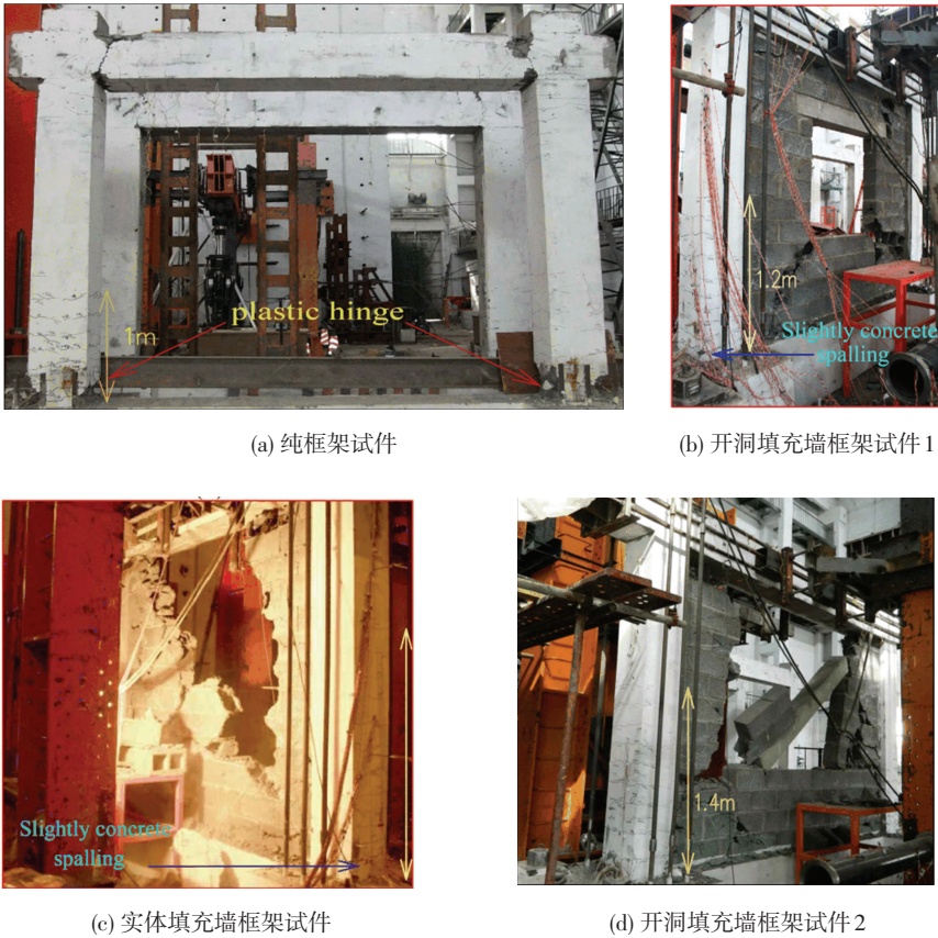
图 1 混凝土空心砌块砌体填充墙 RC 框架结构拟静力试验破坏现象
