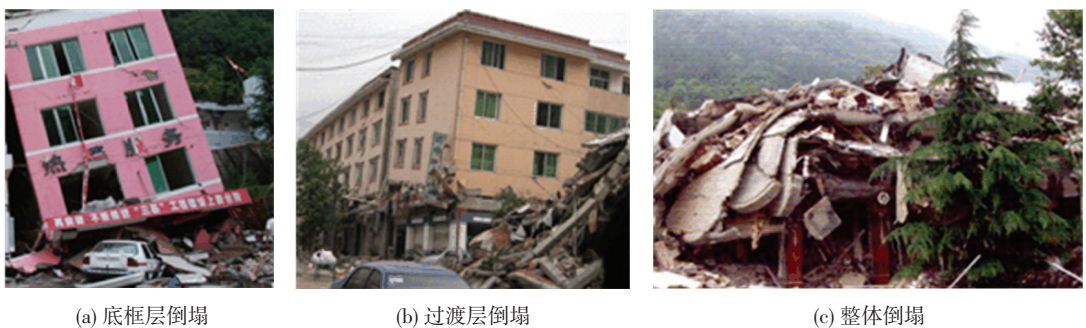
图1 底框结构地震倒塌模式
