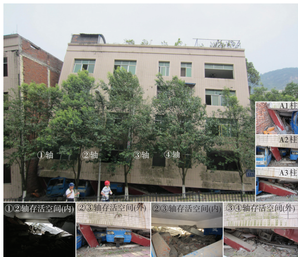
图 3 底框结构 2 废墟图
