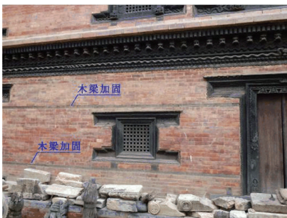
(b) 震后的墙体
