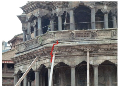
图 14 查辛德嘎神庙的墙体开裂
