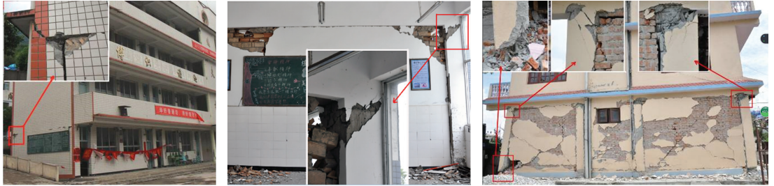
(a) 双石中学逸夫楼(芦山地震Ⅸ度区) (b) 上里中学底层边柱(芦山地震Ⅷ度区) (c) Charikot 自建 RC 框架(尼泊尔地震Ⅸ度区)
