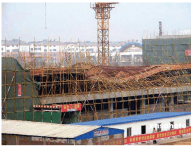
图 1 某体育活动中心施工事故现场
