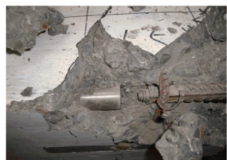
(e) 梁下部钢筋在套筒处断裂
