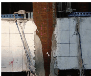
(a) 混凝土开裂
