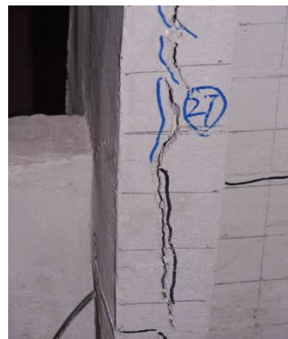
图 3 S-1 试验中拉裂照片
