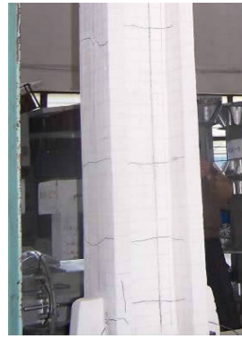
图 2 S-1 表面初始裂缝
