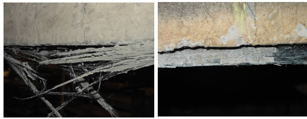
(a)CFRP 布被拉断 (b)CFRP 布剥离
